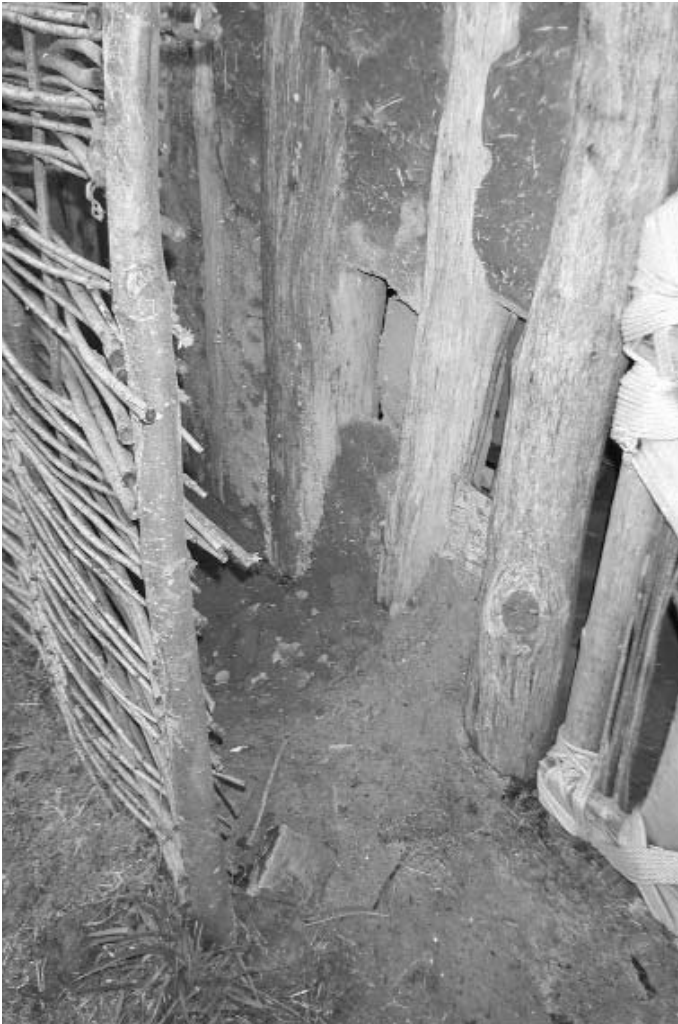
Abb. 8 Auf der wetterexponierten Westseite des Hauses von Pennigbüttel treten regelmäßig – nach starken Regenfällen – Auswaschungen und Rutschungen im Stampflehm der Hauswand auf (Foto: Verfasser).
